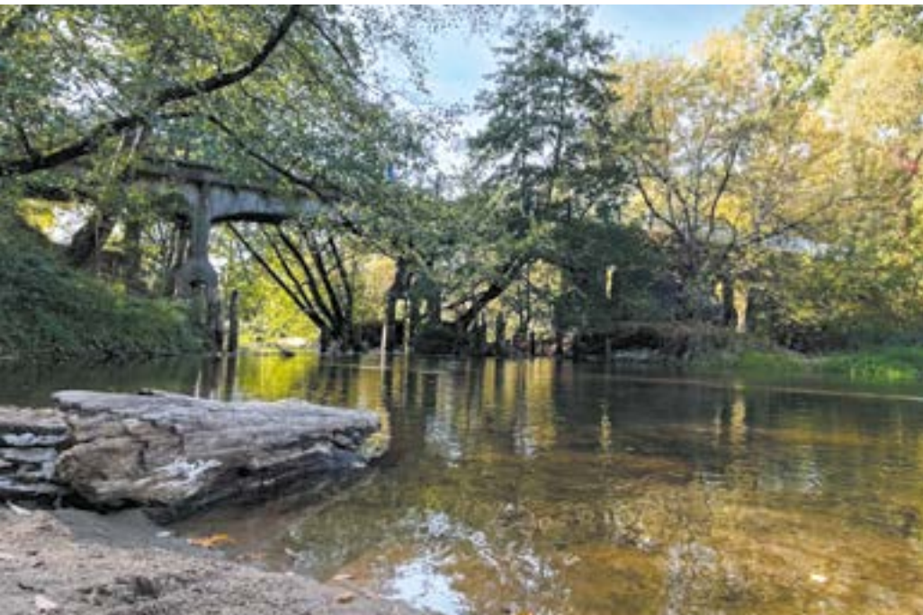
Most pieszo-rowerowy czeka na remont. Fot. KM
